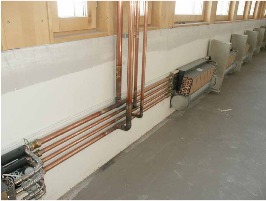
Hårda kopparrör, Cupori 110 Premium, med fabriksstillverkade kapillärrördelar och klämringsskopplingar
