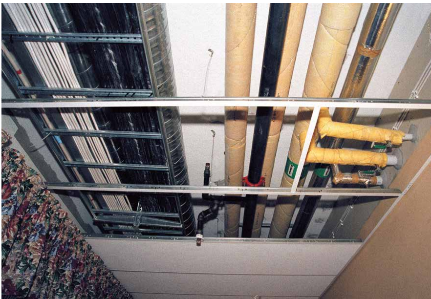
Rör ovan undertak med värme, vatten, kyla, vent och el
