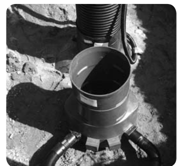
Från fosforfällan leds vattnet till fördelningsbrunnen, varifrån det distribueras till mark/infiltrationsbädden.
