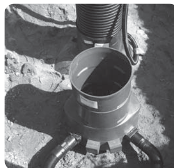
Clean Easy leder vattnet till fördelningsbrunnen, varifrån det distribueras till mark/infiltrationsbädden.
