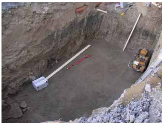
Bild 18. Gräv ett monteringsschakt för tanken. Schaktdjupet varierar enligt det inkommande avloppet. Packa med vibrator ett ca 30 cm tjockt jämnt stenfritt sandskikt på schaktbotten. Använd vatten vid komprimeringen.
