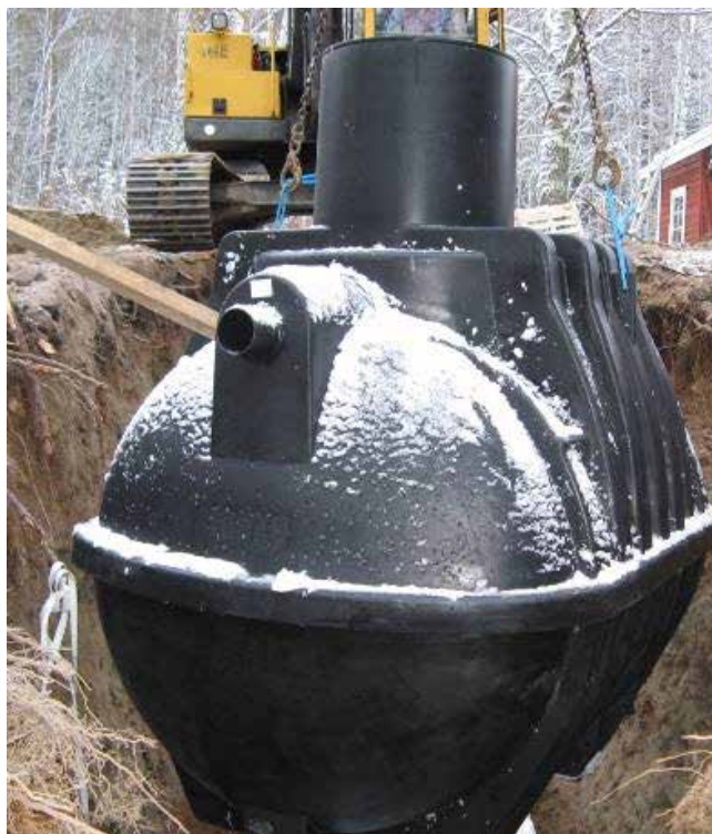
Bild 19. Lyft processtanken in i installationschaktet. Lyft processtanken i lyftöglorna ner i schaktet.
