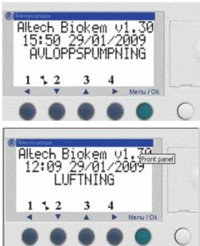
Bild 9. Avloppspumpning och luftning.
