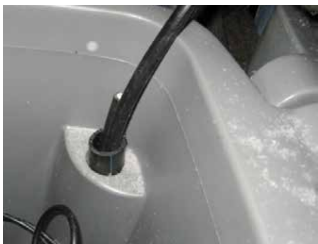
Bild 29. Dra jordkablarna från centralenheten till apparatskåpet, 2 st. (EKKJ 4x2,5+2,5) och märk bägge ändarna på den ena kabeln med samma märken för att underlätta elmontörens arbete. Förläggning utav kabeln skall ske efter gällande standarder. Jordkabeln skjuts in i apparatskåpet genom monterings-skåran baktill.
