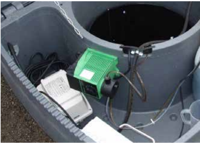
Bild 33. Inspektionsbrunnens genomföringstättning För tömningspumpens elledning och luftningsslangen genom inspektionsbrunnens genomföringstättning. Luftningsslangen installeras i kompressorns tryckluftanslutning med en gummifog och dras åt med två spännrullar. Kemikaliepumpens tryckslang är färdiginstallerad i processtanken.
