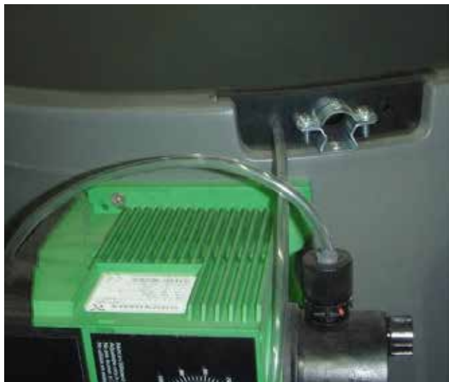
Bild 14. Genomföringen av kompressorns luftningsslang från apparatskåpet till processtanken.
