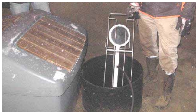
Bild 27. Lyft apparatskåpet bredvid inspektionsbrunnen. I behållarens botten finns luftningsstödet. Tryckluftslangen är fästad i inspektionsbrunnen.
