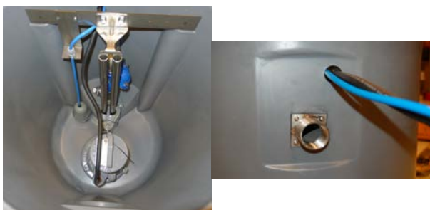
Kablarna från pump och kabel/slang från
