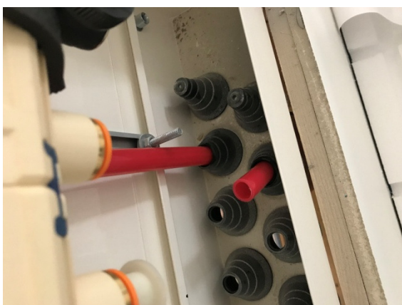
Bild 5 monterade rör genomföringar
