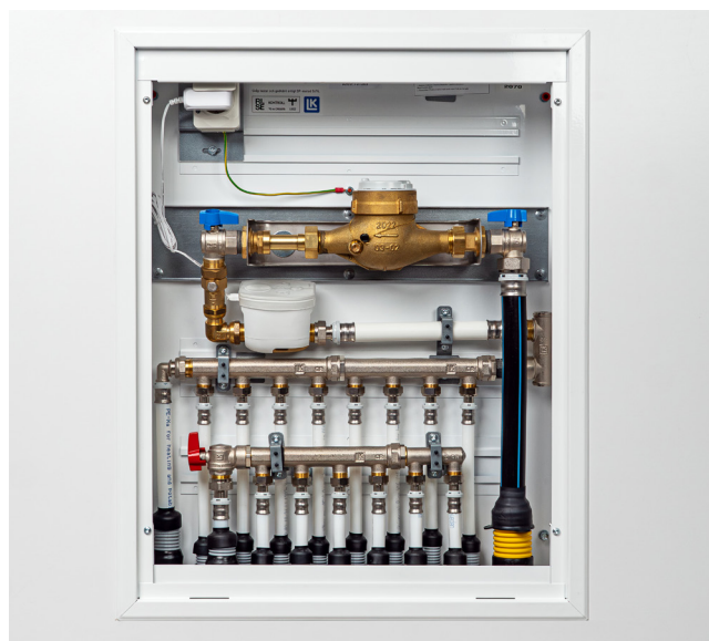
Vattenfelsbrytaren monterad i skåpet.
