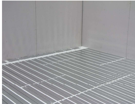
12. Installationen är klar.
