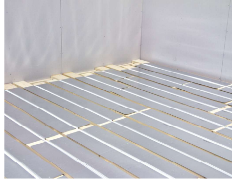
12. Installationen är klar.
