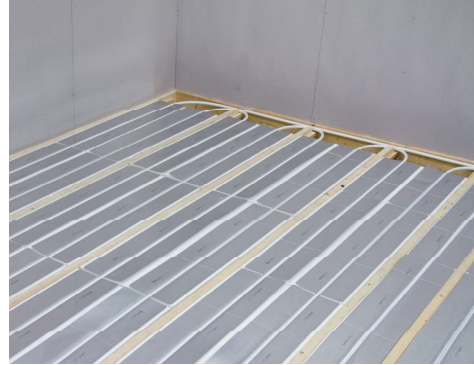
12. Installationen är klar.
