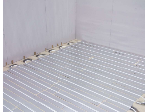
26. Installationen är klar.
