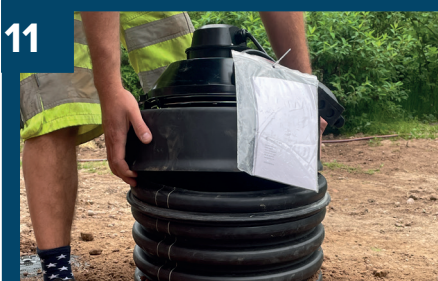
11 Montera lock med fläkt.
