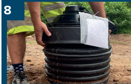
8 Montera lock med fläkt.
