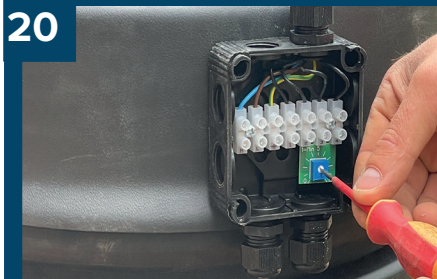
20 Låt en elektriker ställa in rätt flöde.
