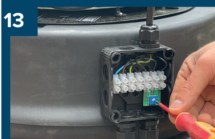
13 Låt en elektriker ställa in rätt flöde.
