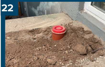
22 Inspektionsrör med tätt lock. Locket täcks med brunnsbetäckning.
