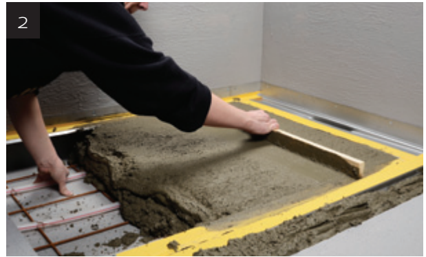
2 Avjämningsmassan eller betongen läggs på i duschplatsen. Avloppsarmaturens inbyggda fall tillsammans med en rätbräda underlättar fallbyggnaden. Därefter kan resten av golvet gjutas upp i nivå med avloppsarmaturens horisontella tätskiktsfläns.
