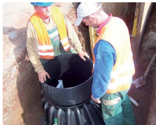
Uppföringsrör på kona
